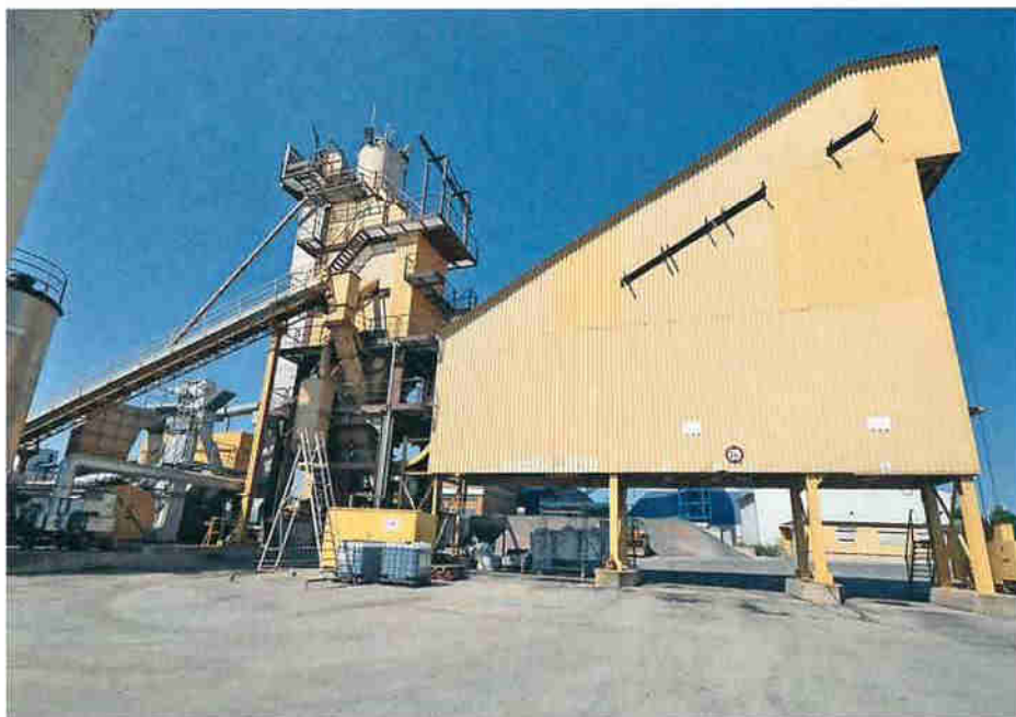
Direkt am Asphaltmischwerk installiert wurde diese Lager- und Dosierstation, die sich gegenüber der gigantisch wirkenden Anlage eher bescheiden ausnimmt
