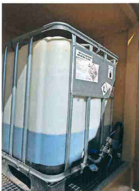
Blick in den Regalcontainer: auf einem der drei Stellplätze wurde hier ein IBC direkt an Dosierpumpe angeschlossen
