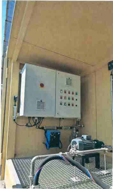
Ausstattung des Regalcontainers mit Schaltschrank, Heizung und Dosieranlage
